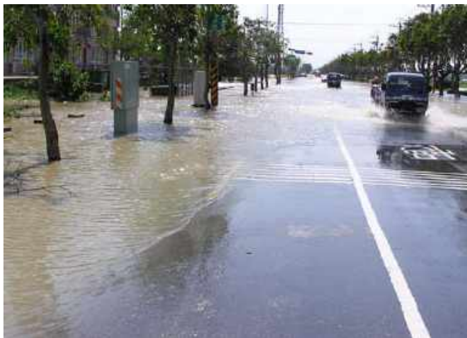
94 年 612 豪大雨造成台南市立德管理學院前，台糖宿舍旁與安中路旁箱涵淹水現況。
